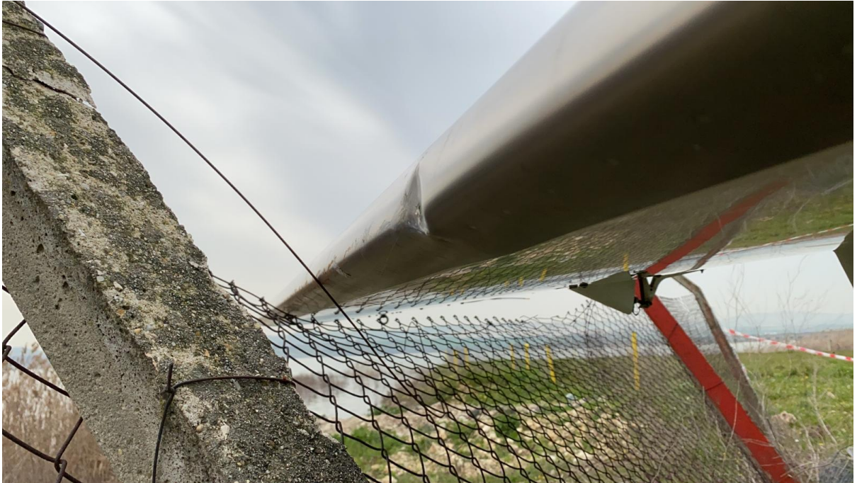
Resim-4: Hava Aracındaki Hasarlar
