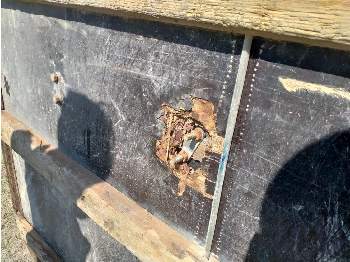
Resim-6: Sepet Hasarı
