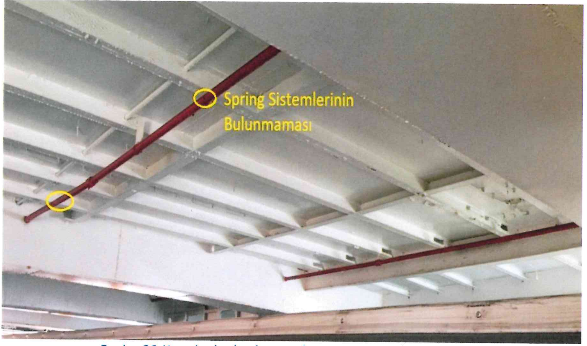
Resim 23 Kapalı alanlarda yer alan yangın söndürme sistemi
