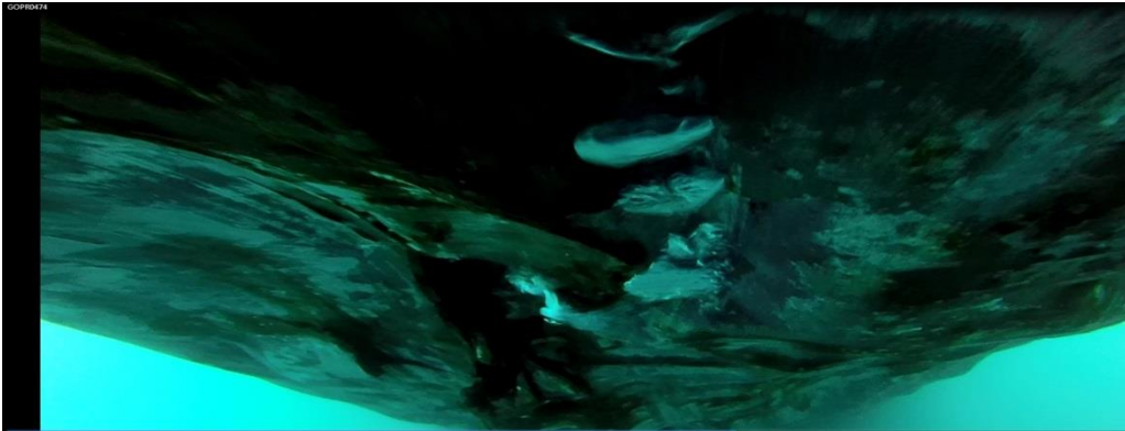
Resim 8 : Dalgıç Kamerası ile Çekilen Hasarlı Kısımlar
