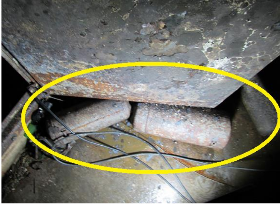
Resim 8: Yangın Söndürme Sırasında Kullanılan Portatif Yangın Söndürücüler
