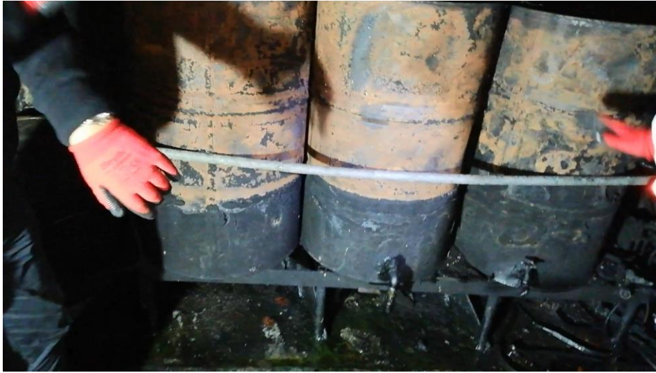
Resim 22: Makine Dairesinde Bulunan Yağ Varilleri
