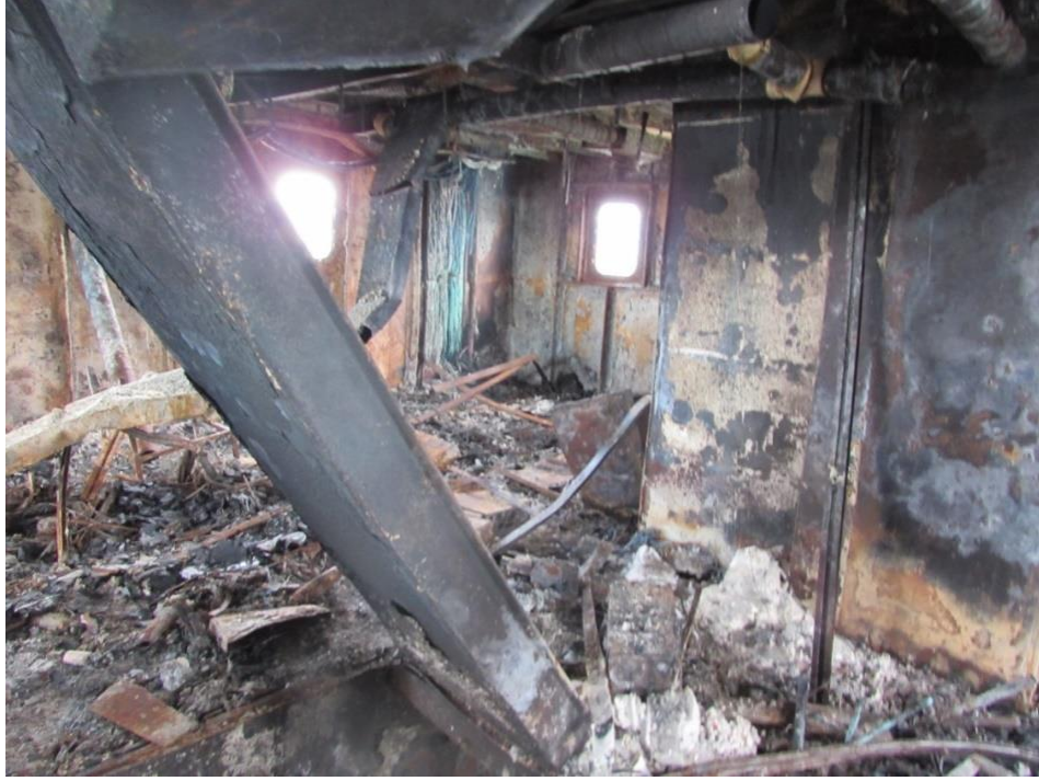
Resim 12: Yaşam Mahalli İçinde Meydana Gelen Hasar
