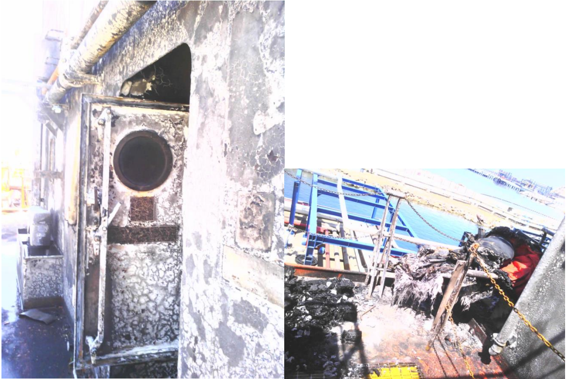
Resim 21: Yangın Nedeniyle Bütünlüğünü Yitiren Ekipmanlar ve İzolasyon Malzemeleri
