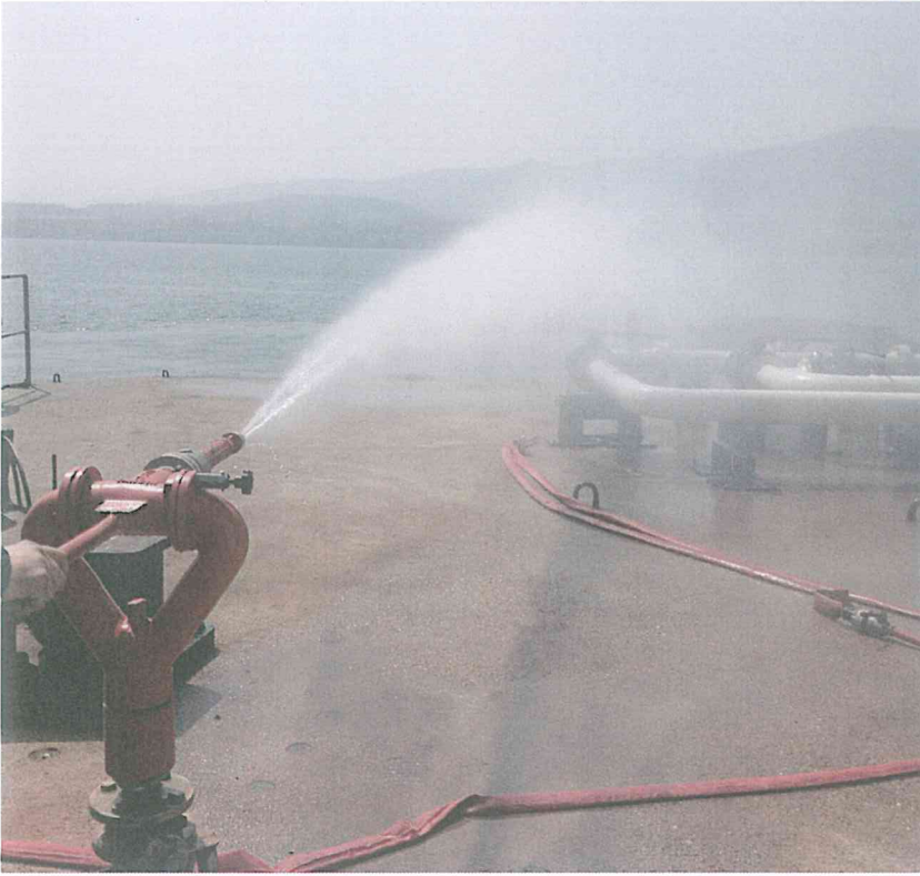
Resim 28: Yangın Söndürme Çalışmalarında Kullanılan Su Topunun Menzili
