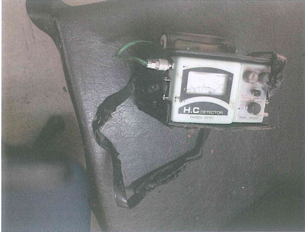
Resim 12:Yangından Hasar Gören Gaz Detektörü
