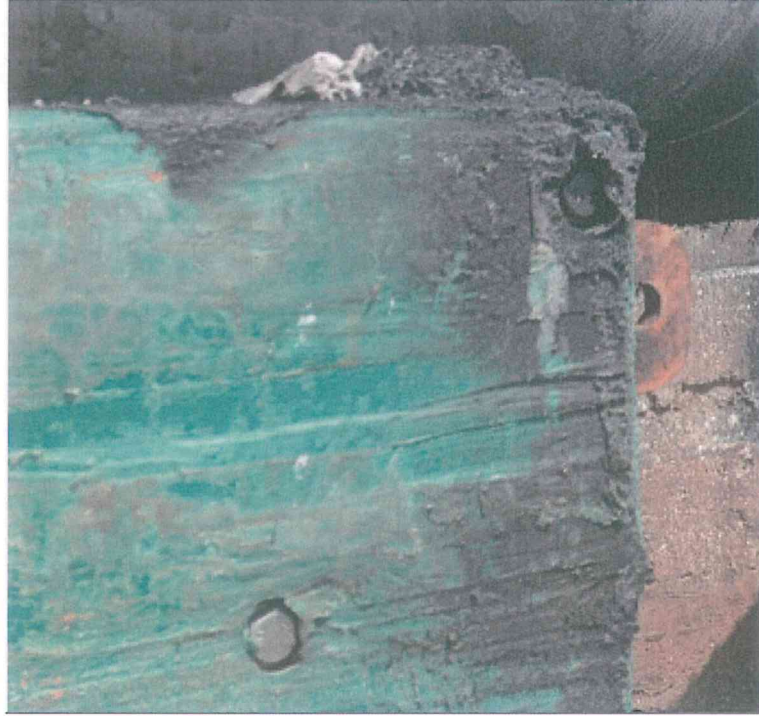
Resim 9:Yangından Hasar Gören Platform Usturmaası
