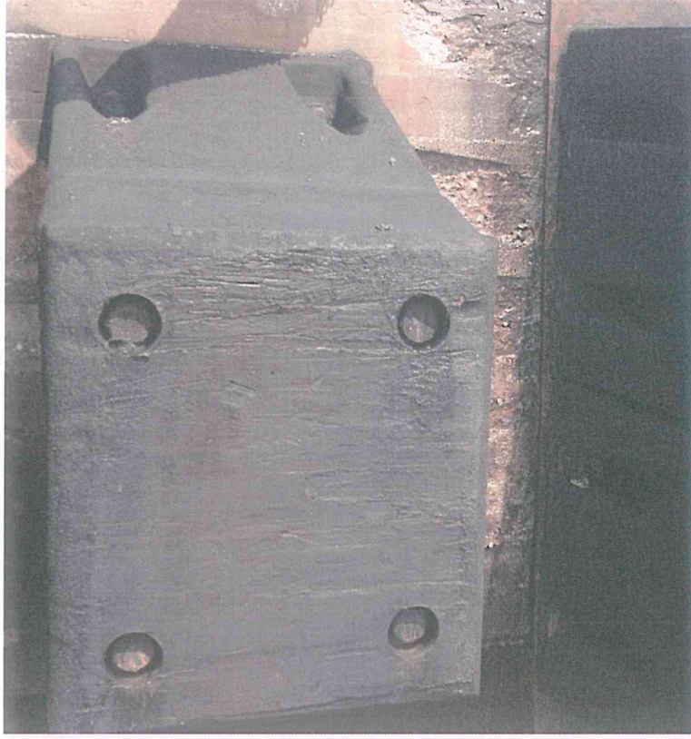
Resim 8:Yangından Hasar Gören Platform Usturmaası
