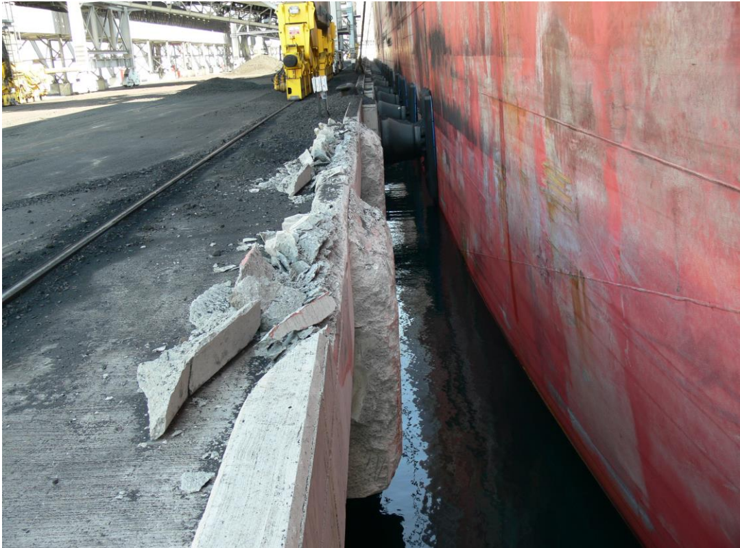
Resim 4: Eren Limanı rıhtımında hasar.
