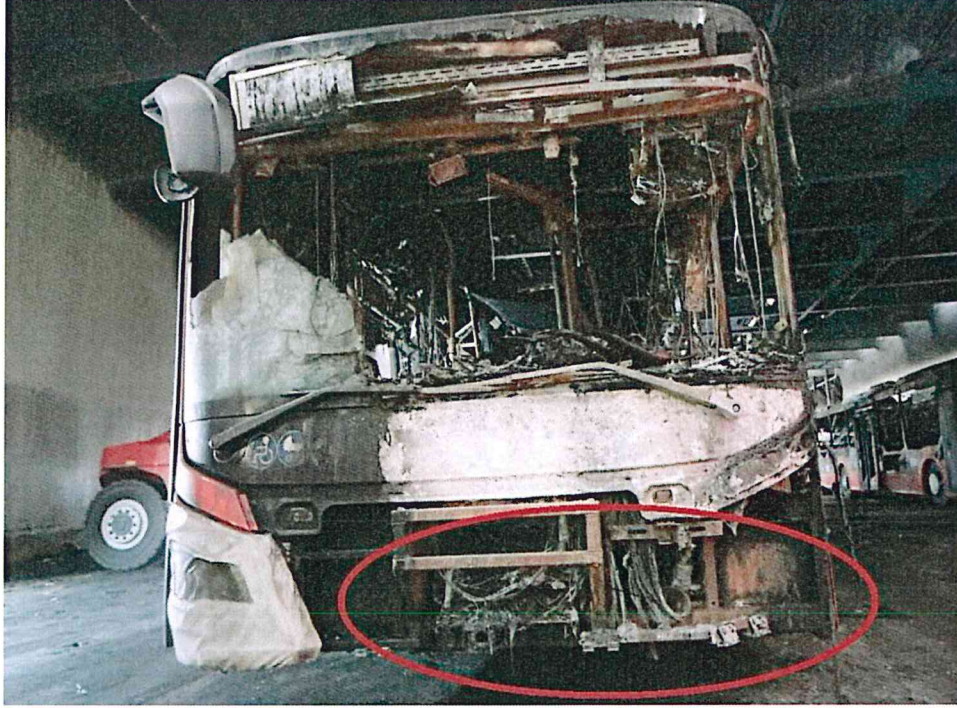
Resim 17 Yangının Başlangıç yeri ve hasar gören Elektrik kabloları.
