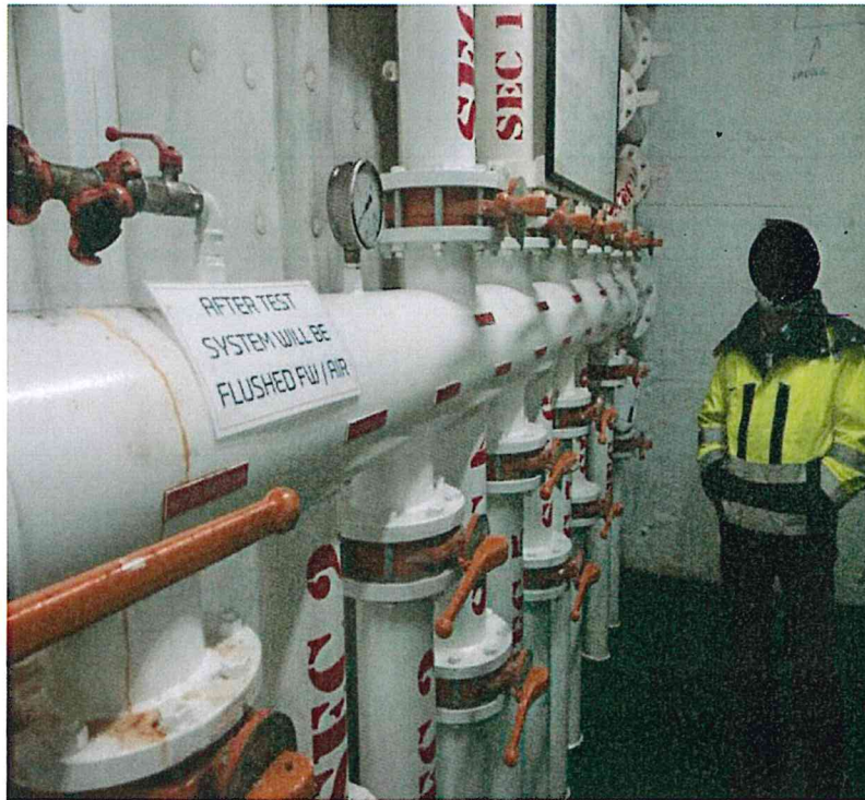
Resim 24 Yangın söndürme istasyonu kumanda merkezi.
