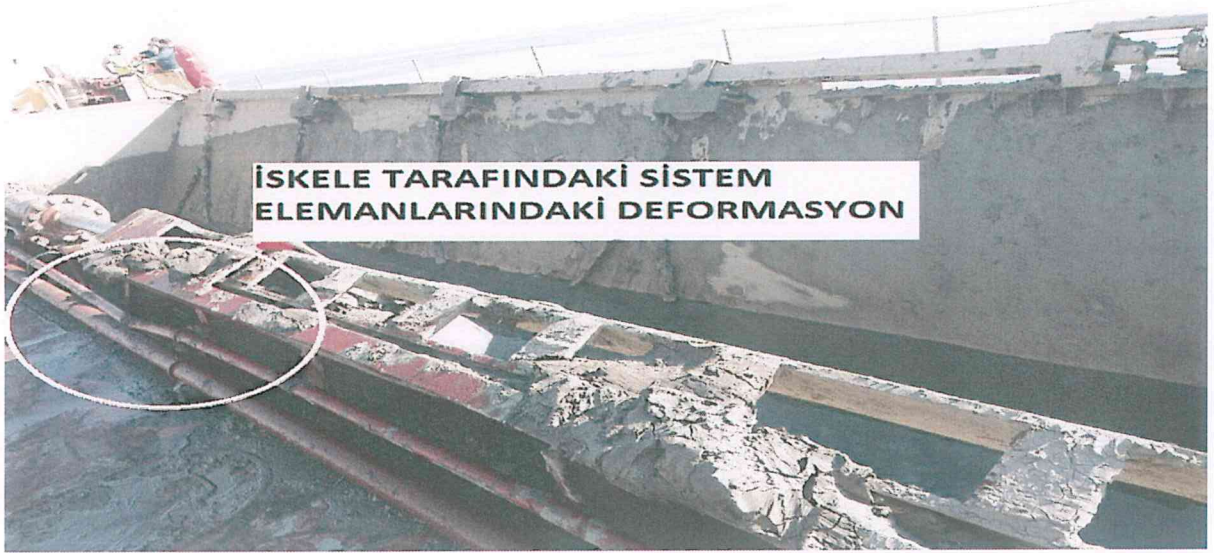
Resim 13: Güvertedeki Hidrolik Sistem Borularındaki Deformasyonlar
