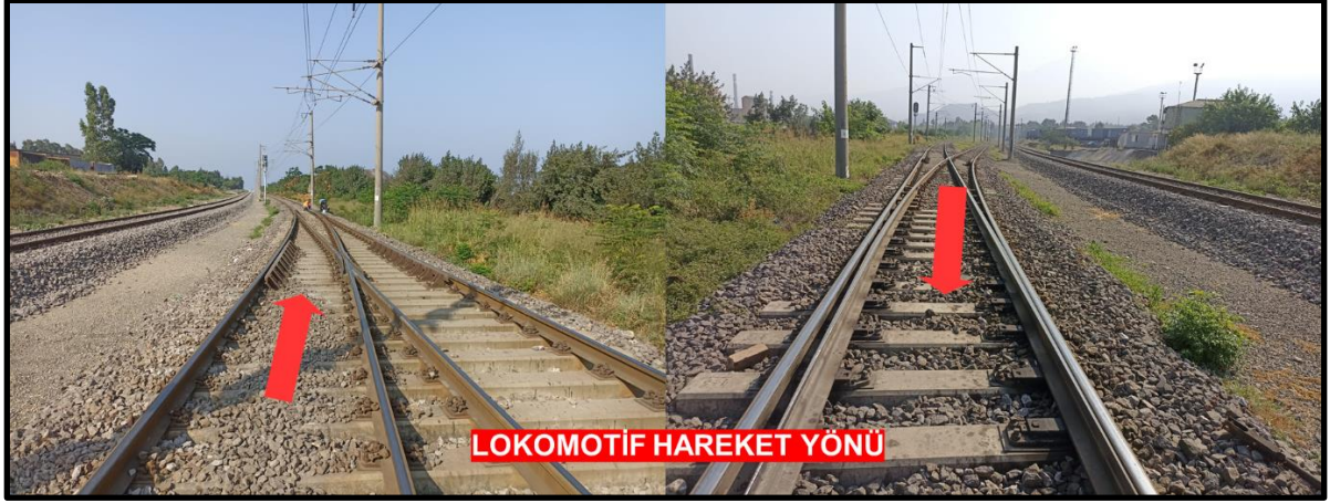
Şekil 4 İsdemir İstasyonu Sarıseki Yönü 01 Nolu Makas
