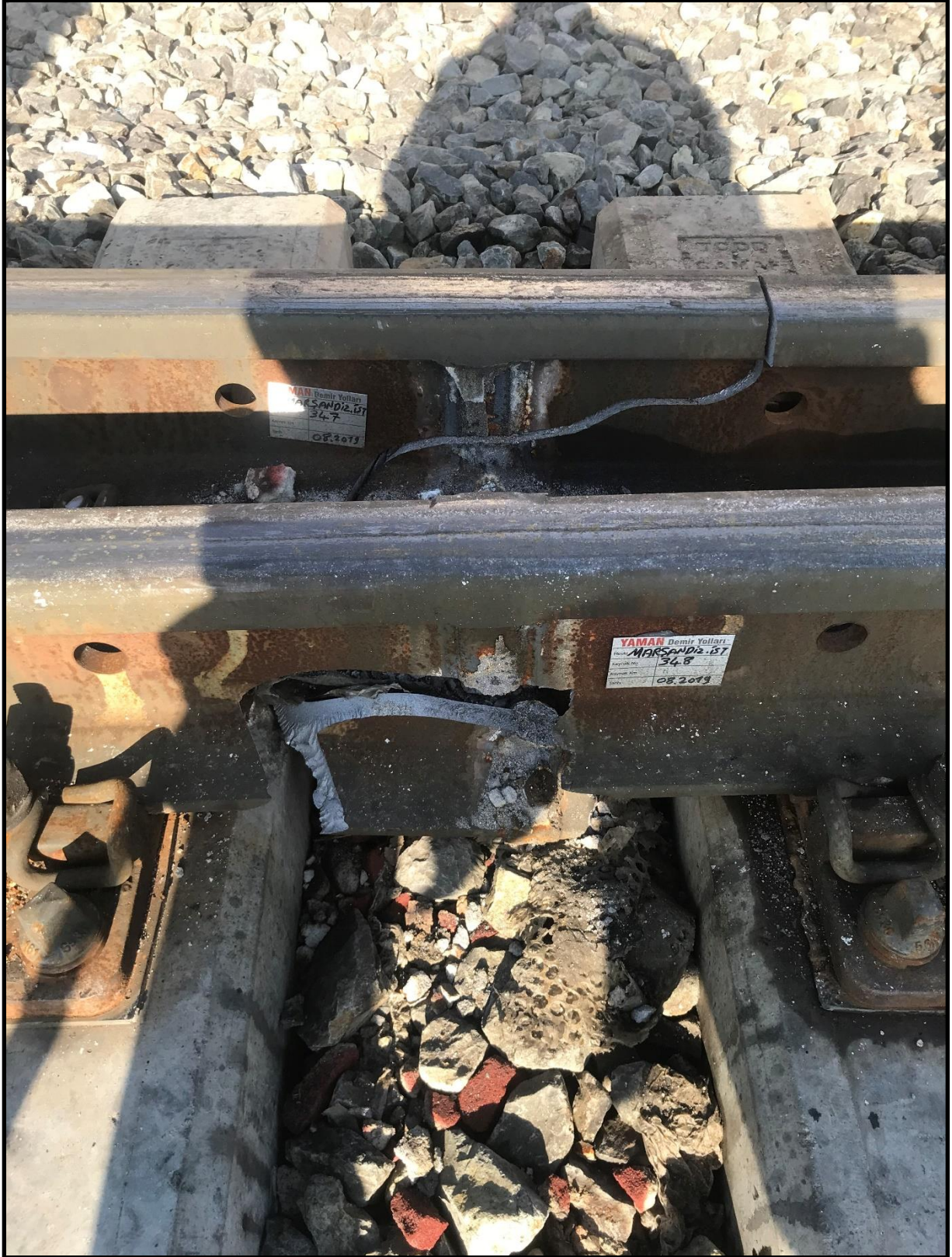
Resim 13 (Hasarlanan makas ara rayları)
