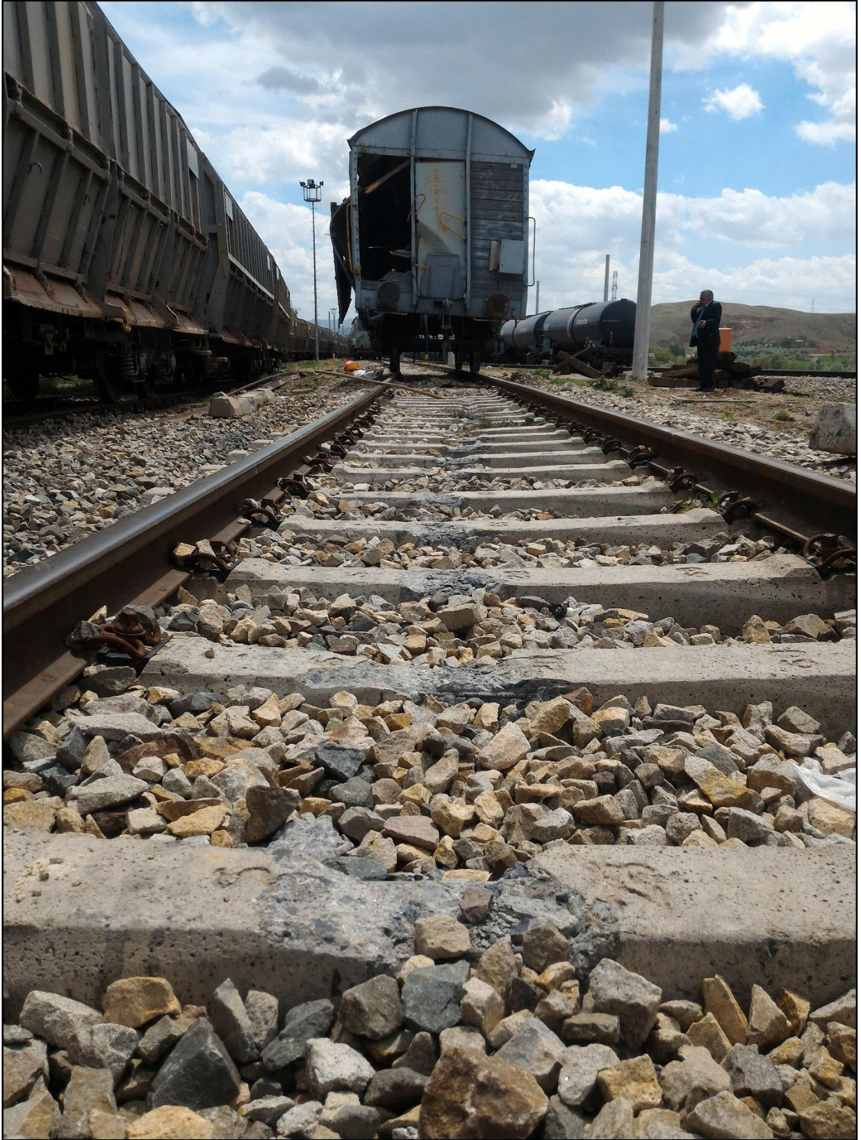
Resim 15 : (Hasar gören beton traversler)
