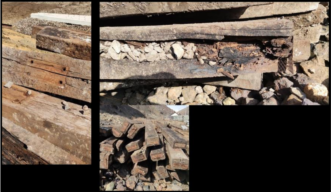
Şekil 9 Kazadan Sonra Sökülen 06D Makasa Ait Traversler
