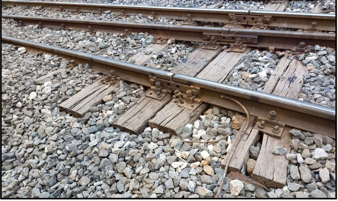
Şekil 8 Kazadan Sonra 06D Makasın Ara Raylar, Küçük Yol Malzemeleri ve Traversler
