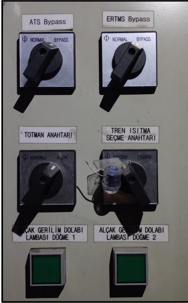
Resim 4 (ERTMS Bypass Anahtarı)
