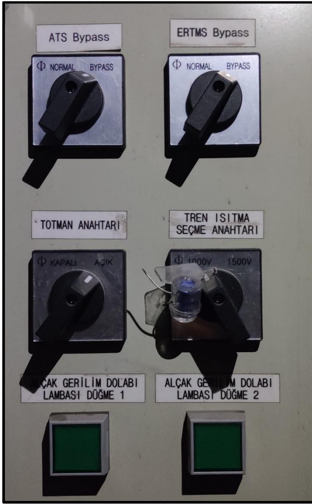
Resim 4 (ERTMS Bypass Anahtarı)
