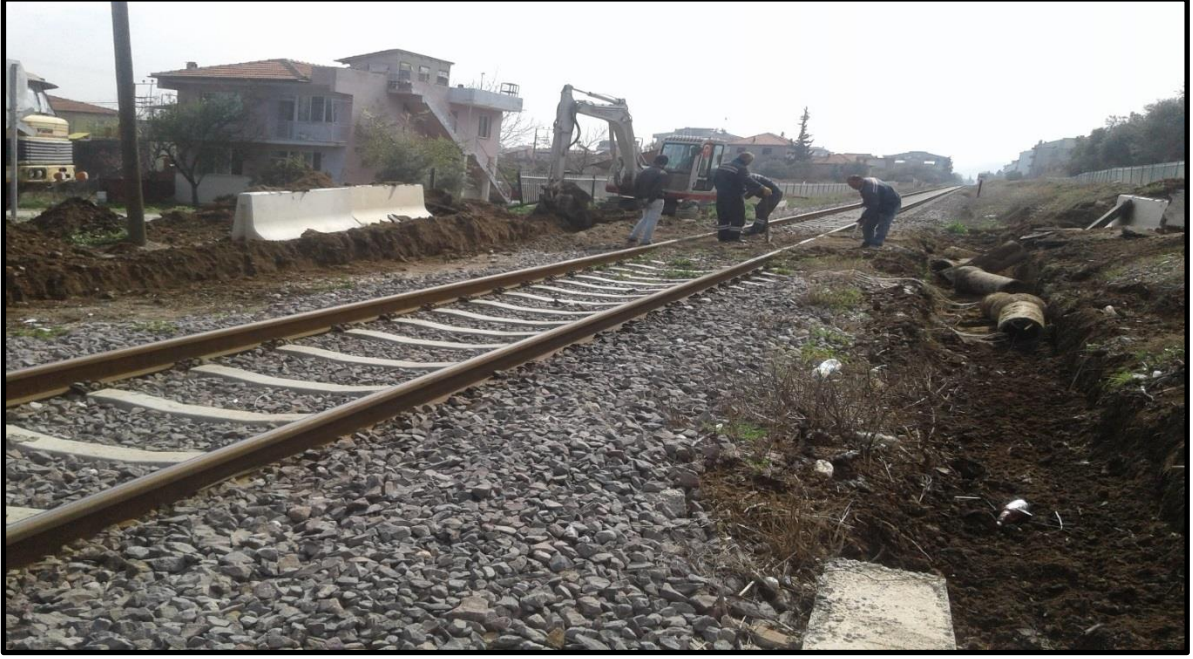
Resim 9 (Hemzemin Geçidin Kaza Sonrası Kapatılma Çalışmaları)
